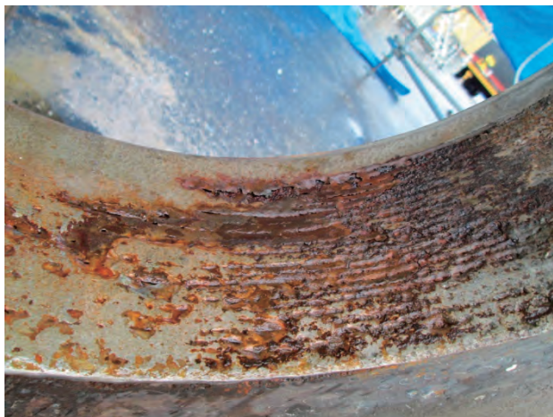
写真 20 軸受部腐食状況
