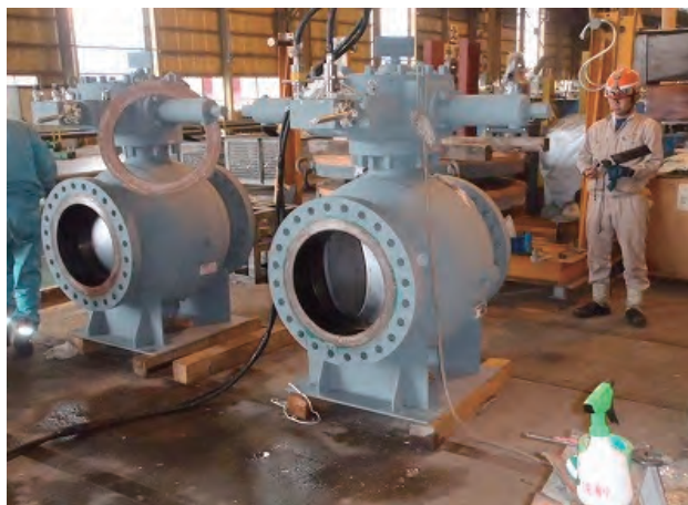
写真13 20B ボール弁作動試験
