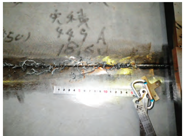
写真15 アーク切れによるトラブル
