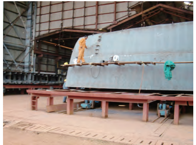
写真 11 墜落防止装置、昇降装置の無い足場上の作業者 (偶然にも、この時だけはヘルメットも未着装)
