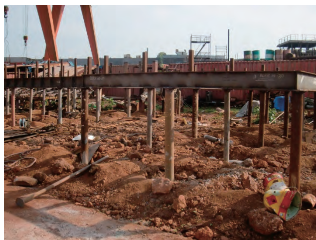
写真3 ブロック組立定盤の一部
