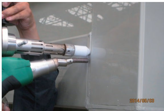
写真2 塩酸槽 (PP 溶着状況)
