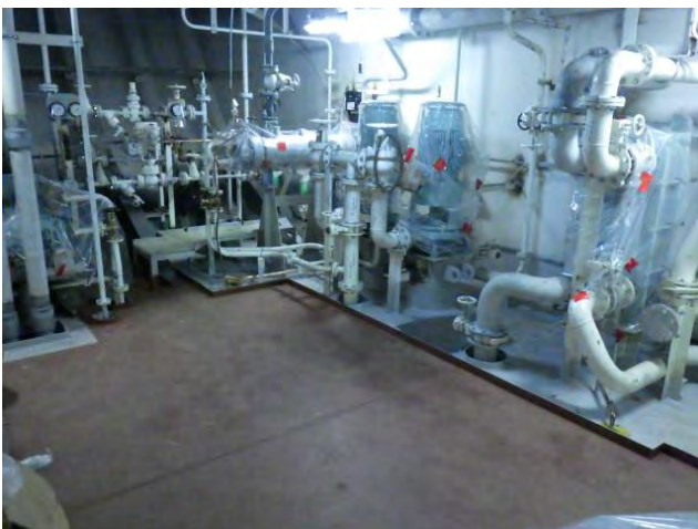
写真 23 クリーンな機器類 (進水前)
