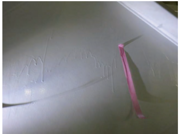
写真2 塗膜のタレ（スプレー塗装後）
