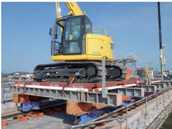
写真 26 桁上移動クレーン設備
