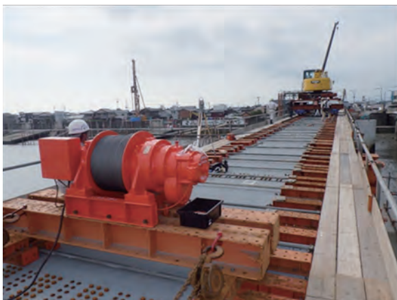
写真 27 ウインチ設備
