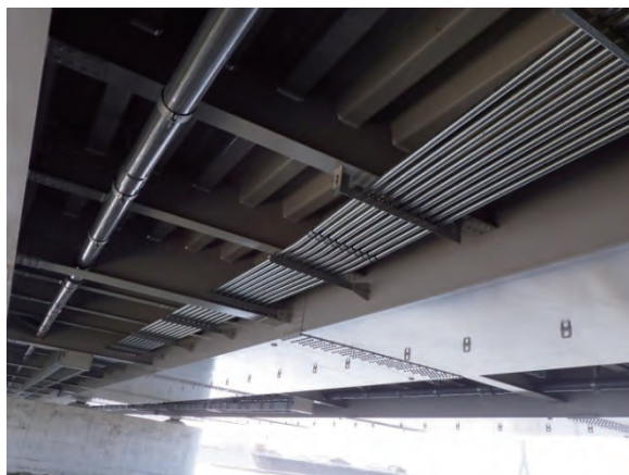
写真 33 排水管・光ケーブル管
