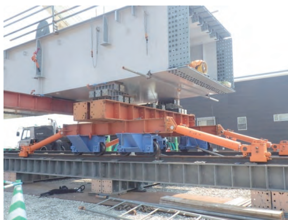
写真 19 縦送り推進設備
