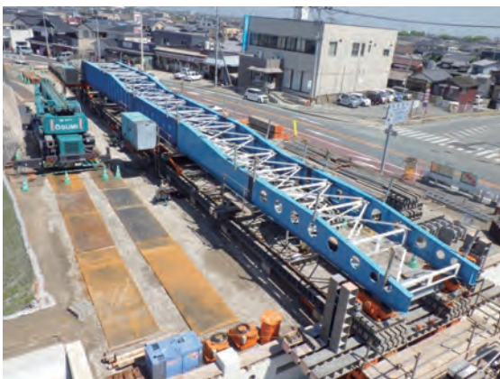
写真8 手延べ機連結構
