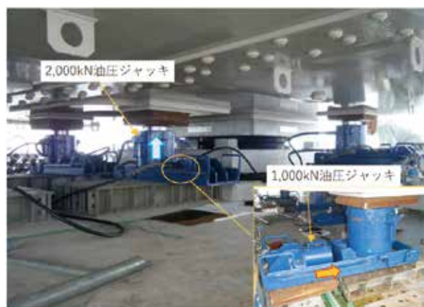
写真8 桁調整装置（油圧ジャッキ設備）
