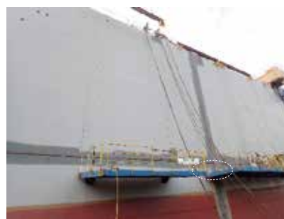
写真 25 動力架設線を躲せずに隙間が発生
